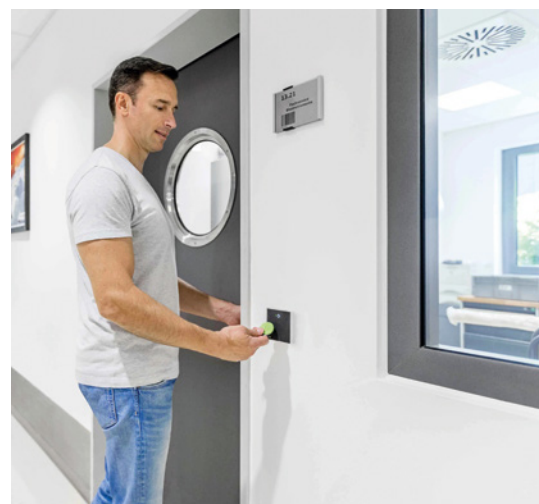
Zutritt mittels Transponder an einem RFID-Zutrittsleser (Foto: PCS Systemtechnik)
